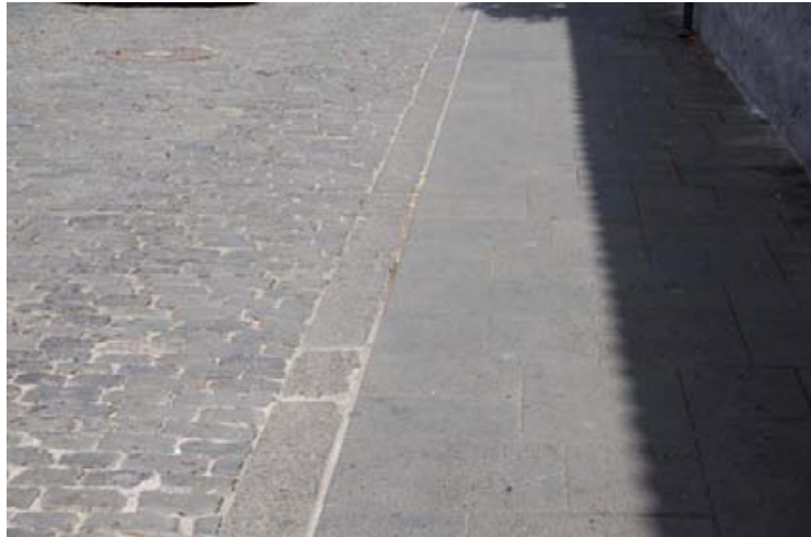
Foto nº 21: Mezcla de adoquinado y pavimento liso en la Calle Carrera.
