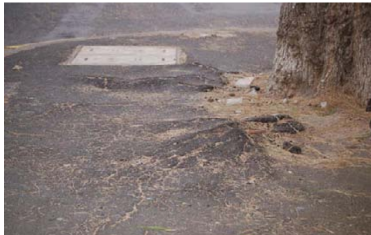
Foto nº 20: Acera afectada por raíces.
