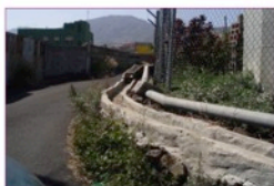
3 Las canalizaciones hidráulicas, muchas de ellas, son abiertas y están en mal estado de conservación.
