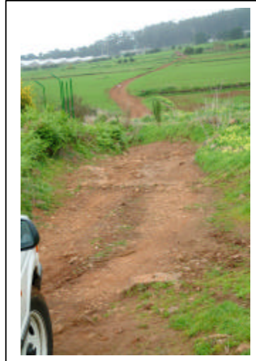
Foto 2 - Unidades: Firme del camino Lomo del Aire en mal estado.
